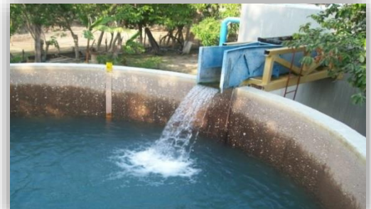
Ilustración 4. Tanque de contacto
