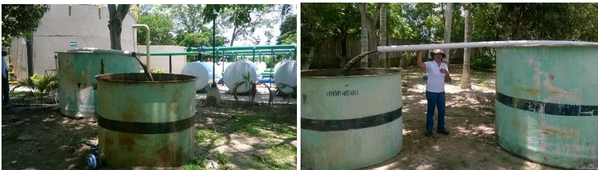
Imagen 10. Vista del drenaje de los lodos por succión.
