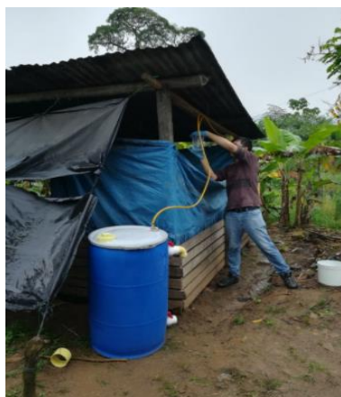
Figura 41. Instalación completa biodigestor. "Elaboración propia".
