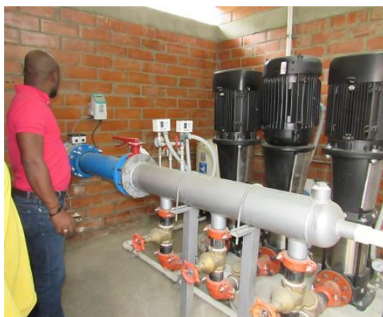
Figura 10 Estación de bombeo agua tratada
