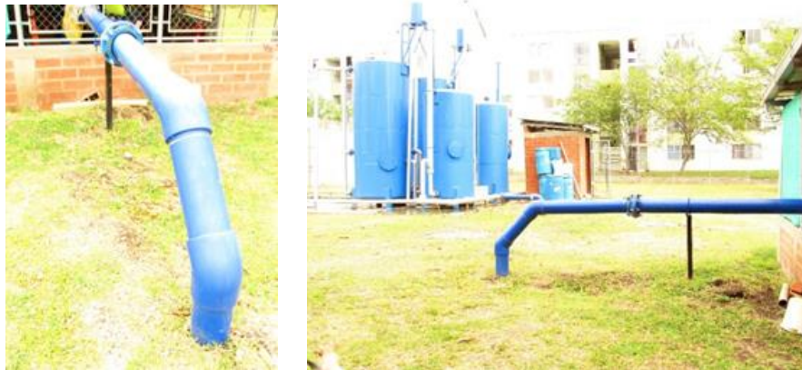
Figura 3 Salida a Ptap vista frontal y lateral salida a Ptap.
