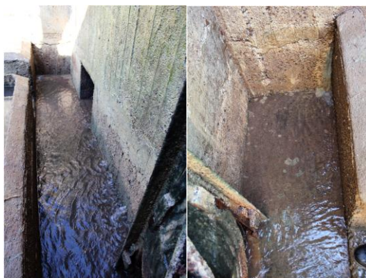
Figura 10: filtraciones en filtros
