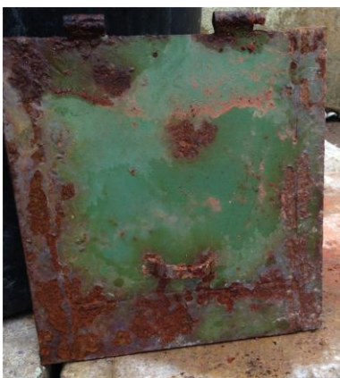
Figura 8. Compuertas de orificios de desagües de floculador.
