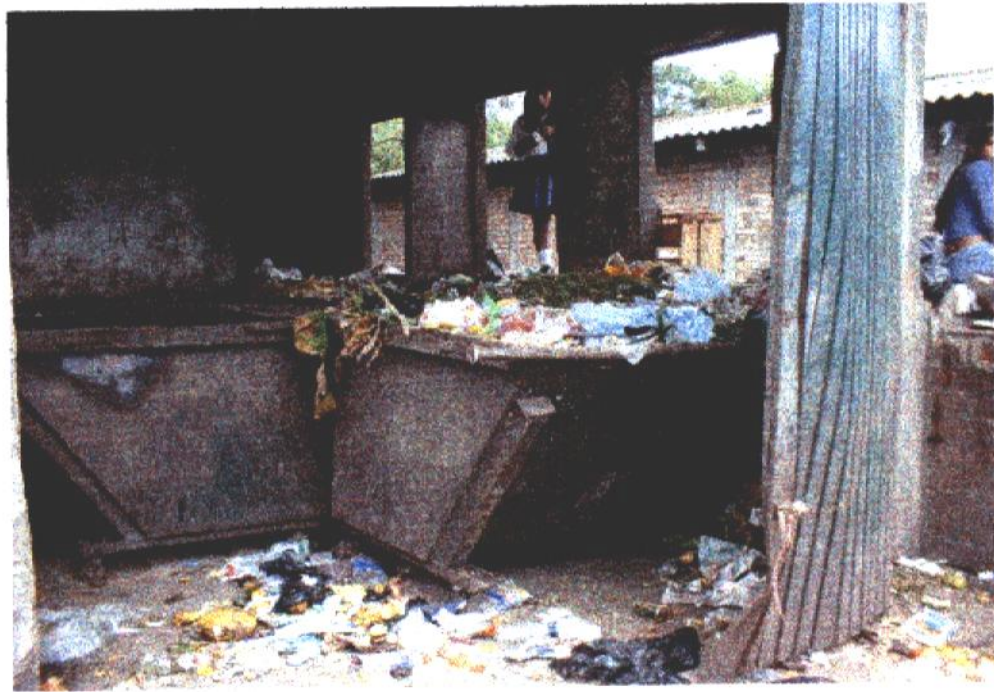
FOTO 5. CUARTO DE BASURAS
