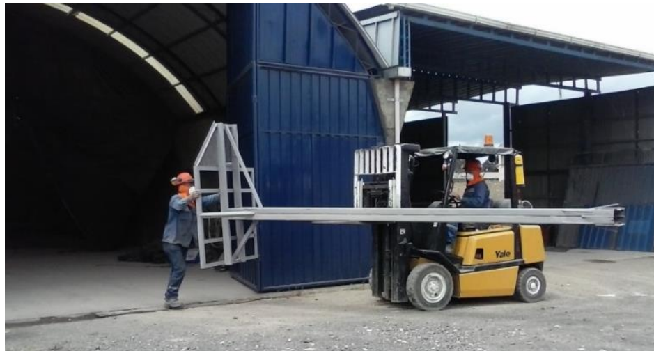
Imagen 4. Salida de la estructura de la bodega de Sandblásting en SEMITEC S.A.S.
