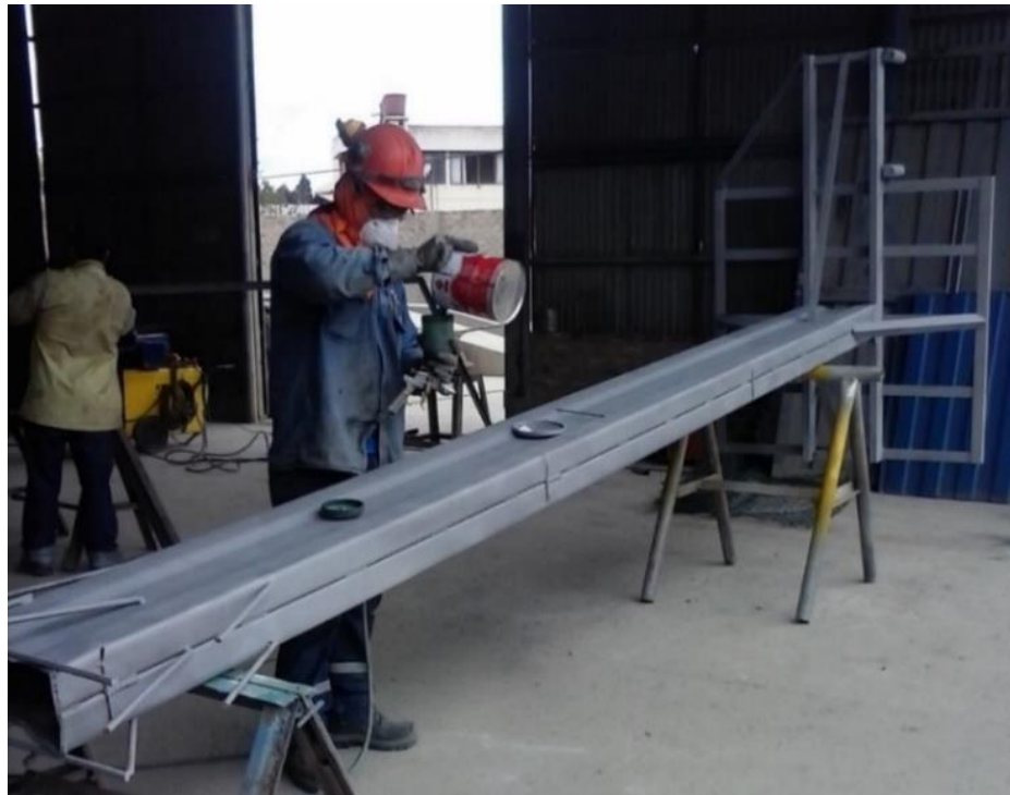
Imagen 7. Preparación y aplicación de anticorrosivo en la bodega de Pintura de SEMITEC S.A.S.
