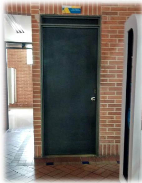
Figura 21. Puerta de acceso a la sala del servidor central CEAD Ibagué
