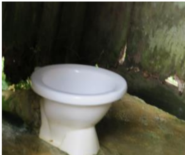
Foto 8. Batería sanitaria, tipo taza campesina. (Fuente PNN AFIW)
