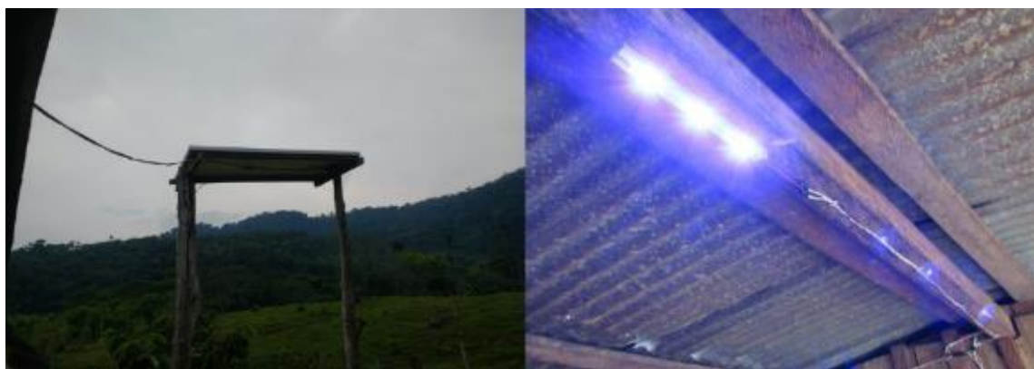
Foto 4. Energía Alternativa Fotovoltaica- Panel solar. (Fuente PNNAFIW)
