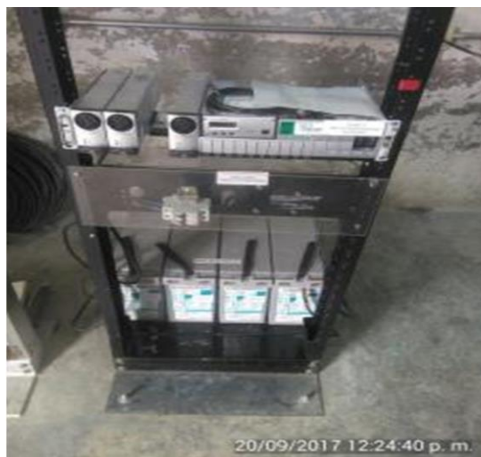
Figura 10. Banco de baterías nodo B aires. Copyright 2017 por J F reinosa.
