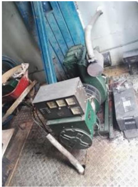
Figura 3. Planta eléctrica Nodo B Aires. Copyright 2017 Por J F reinosa.
