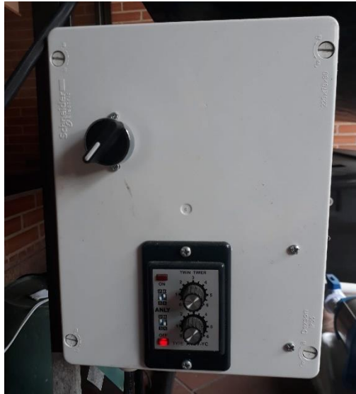
Fotografía 6. Tablero de la parte de potencia con selector y timer
