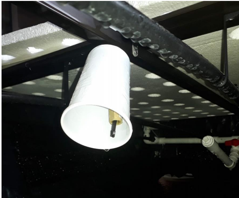
Fotografía 10. Sensor SHT10 instalado dentro de la cama Aeropónica, sin la tapa plástica y con campana para protección
