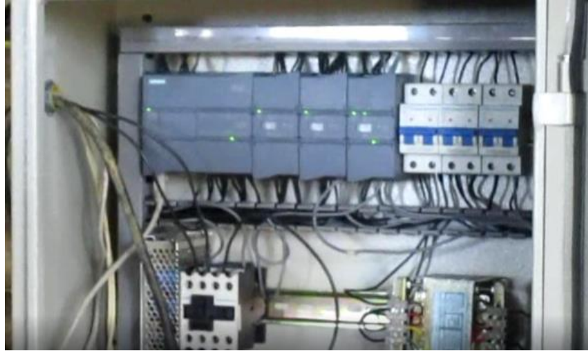
Fotografía 11. Tablero de control del sistema Aeropónico de la empresa Aeropónicos de Colombia S.A.S
