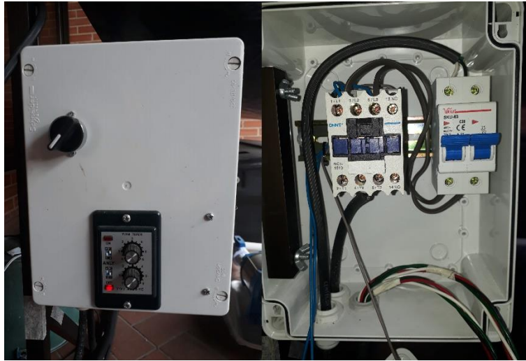
Fotografía 16. Tablero de la etapa de potencia
