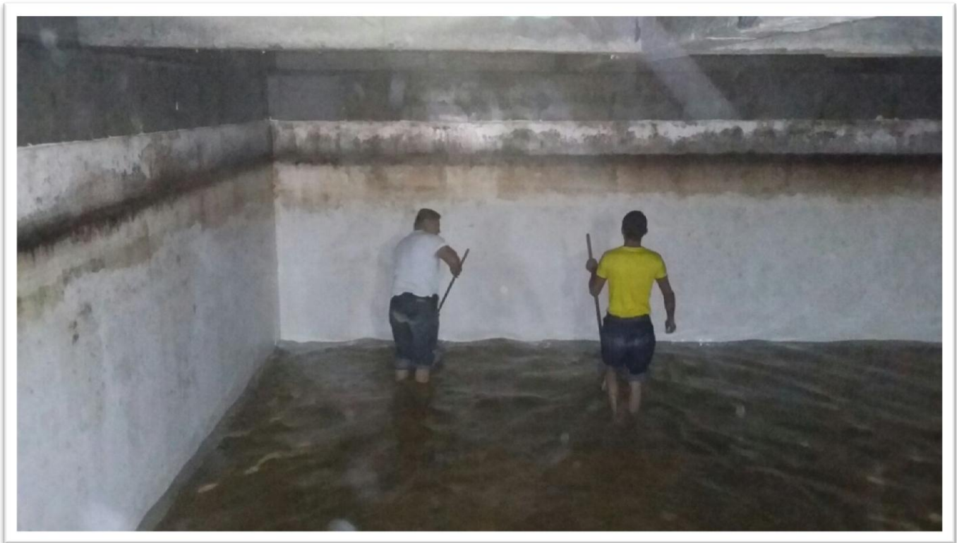
Fotografía 2 Estado tanque de almacenamiento agua potable inicialmente
