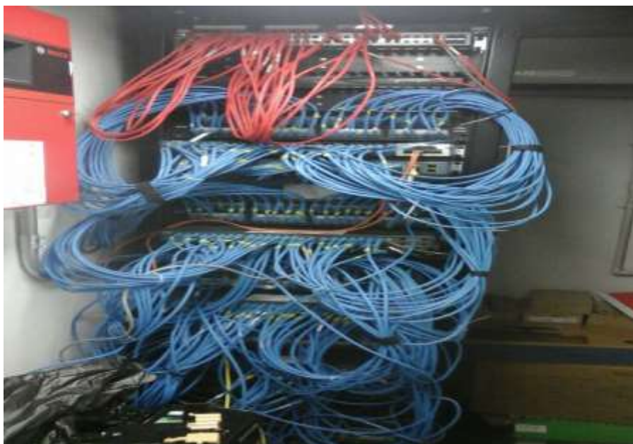
Figura No.6. Vista actual del cuarto de cableado
