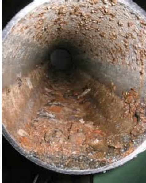
Figura 22. Corrosión en el interior de un tubo.
