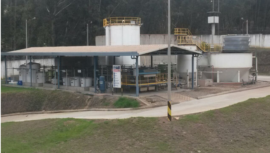
Figura 6. Planta de tratamiento agua industrial proceso autogeneración cementos ARGOS planta Sogamoso
