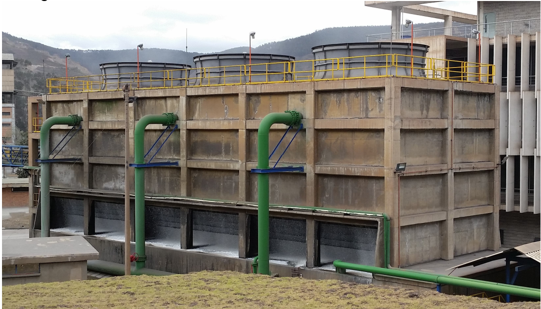
Figura 19. Torre de enfriamiento proceso autogeneración, cementos ARGOS planta Sogamoso.
