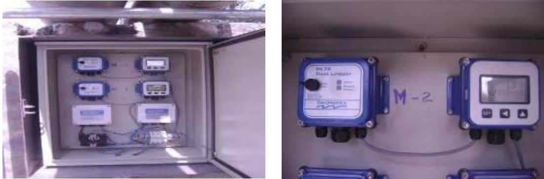
Fig. 19 y 20 Caja de controles, registro de datos (m 3 ) captados del río Fraile al reservorio.
