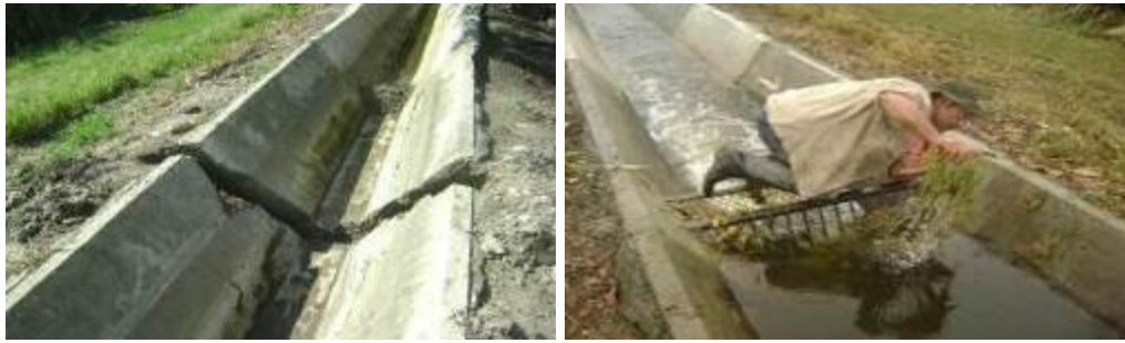
Fig. 6, 7 Instalación de rejillas y limpieza por parte del bombero o regador.
