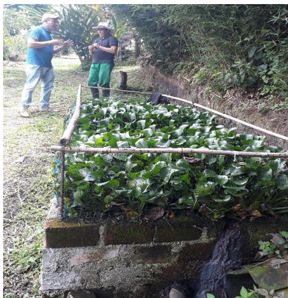
Fotografía tomada por: Francy Castillo Tratamiento de aguas residuales
