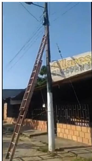
Figura 13 Caja NAP de primer nivel, fuente propia.
