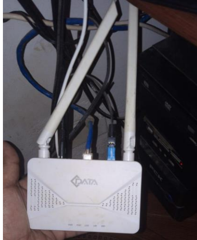
Figura 15. Instalación de un cliente, fuente propia.
