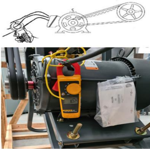
Figura 42 Medición de amperaje
