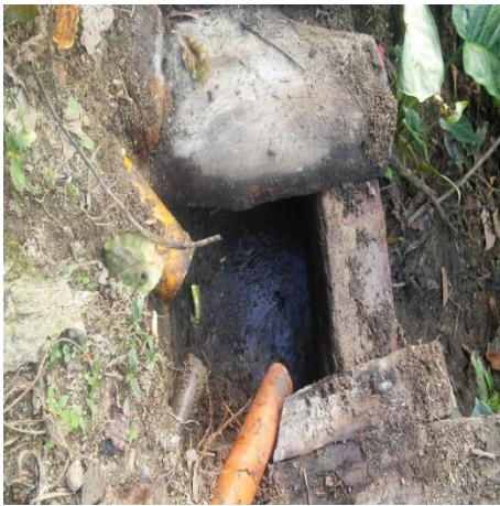
Fig. 1. Pozo de aguas residuales Fuente: El Autor
