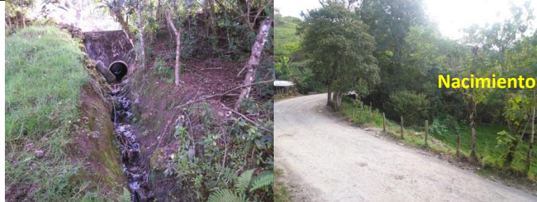
Figura 65: Contaminación vial y por alcantarillado Nacimiento el Manantial
