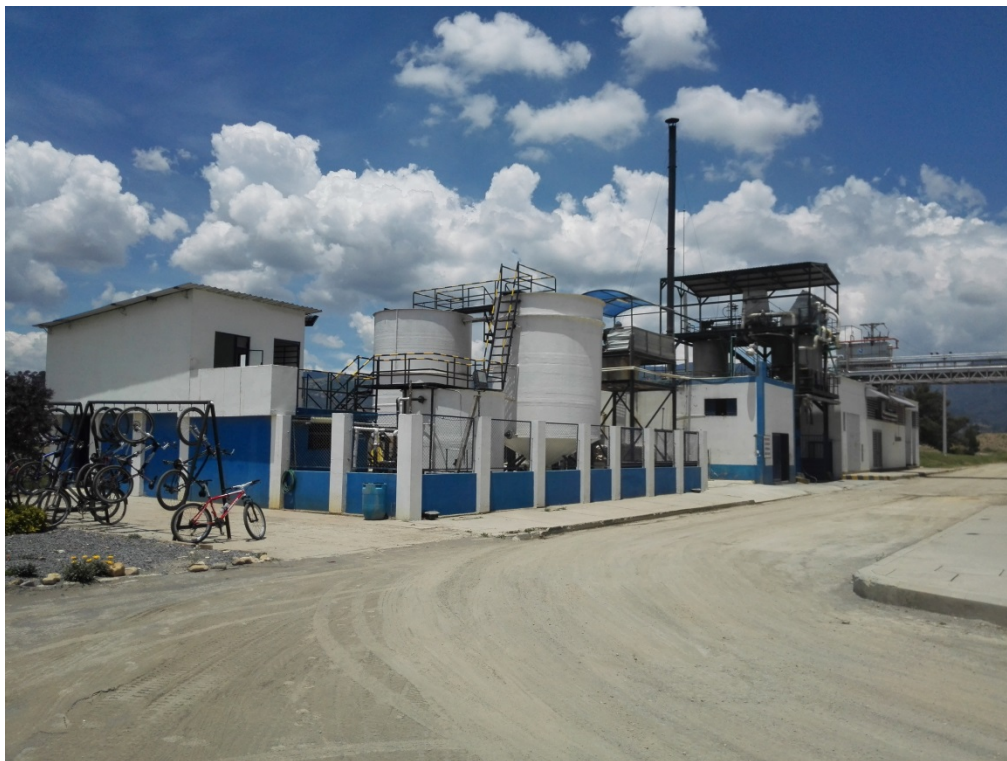
Figura 7: Planta de Tratamiento de Aguas Residuales No Domésticas – PTARND.
