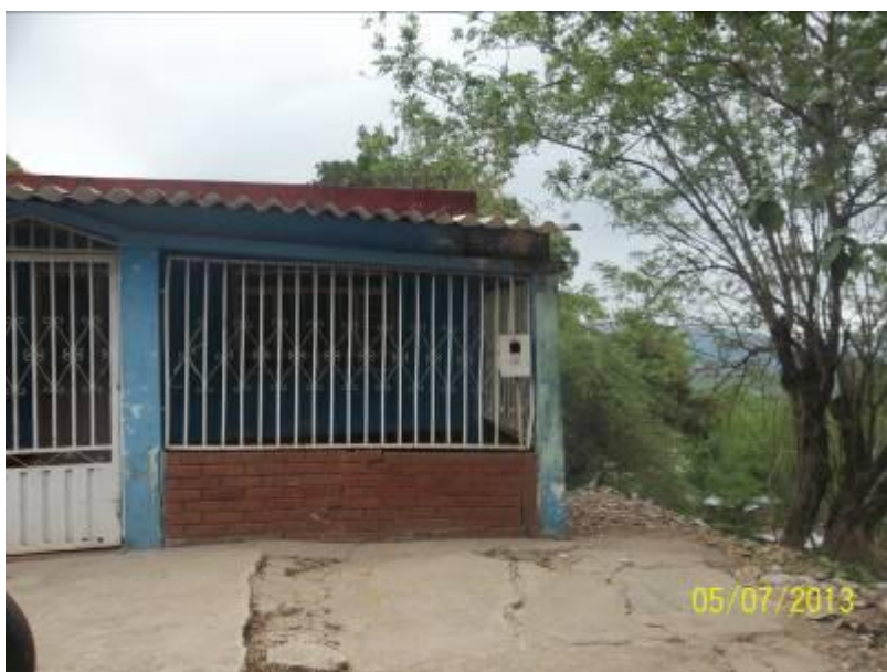
Foto 4. Detalle de la superficie de ruptura en la vivienda y grietas existentes en la misma
