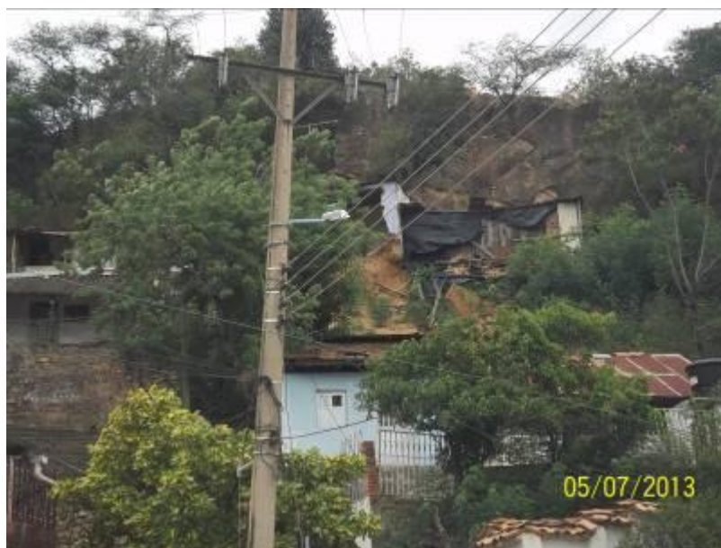
Foto 8. Vivienda afectada por el deslizamiento
