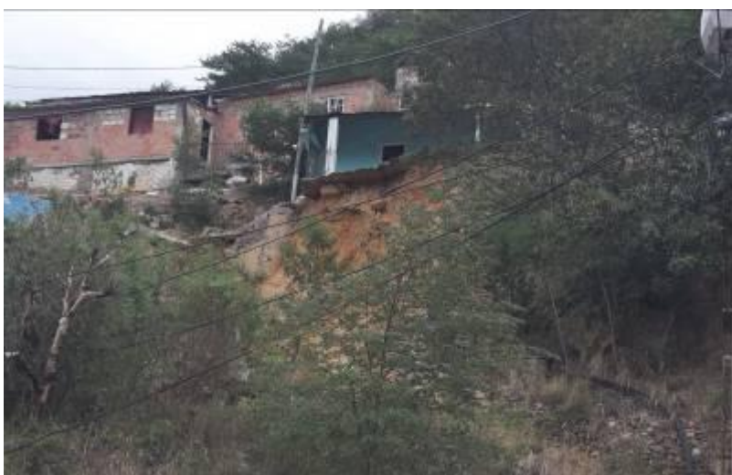
Foto 6. Vivienda ubicada en zona de afectación
