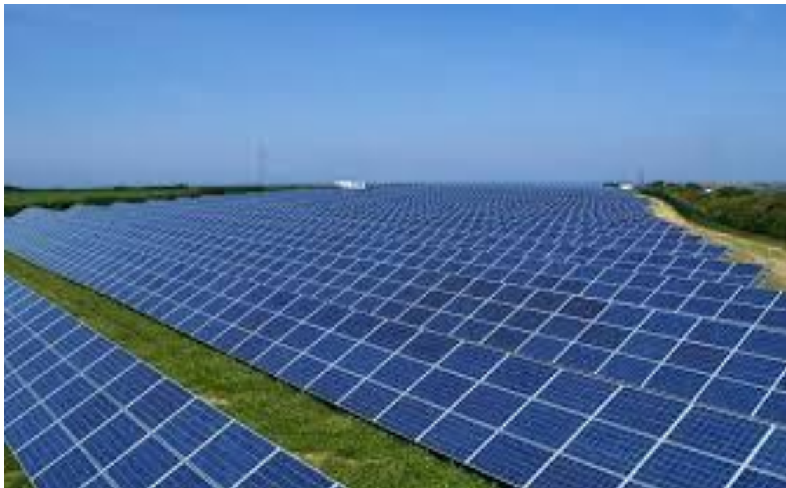
Figura 33 Instalación Solar Fotovoltaica
