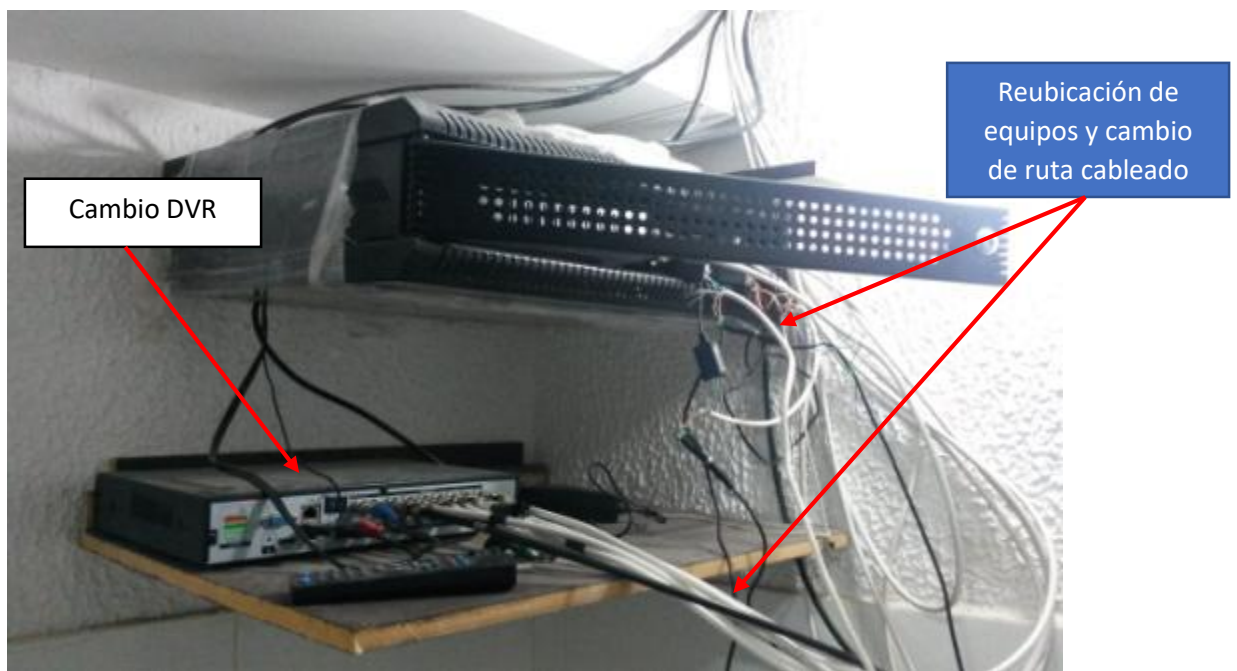
Figura 5. Componentes para organización y adecuación CCTV
