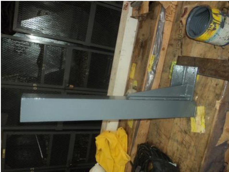
Fuente, registro de Estructura finalizada. Retoque de anticorrosivo gris. Autor William Ortega Lubo
