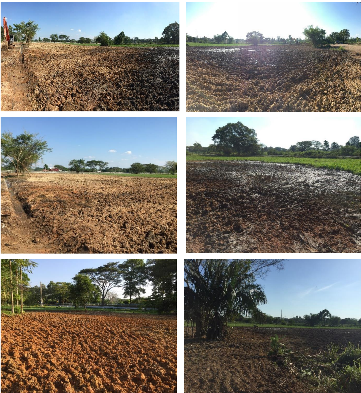
Ilustración 9. Avance de Degradación Biológica de Lodos en el Pozo Casabe 801.
