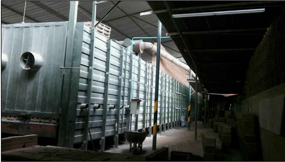
Ilustración 11.Horno Túnel Ladrillera Emalco
