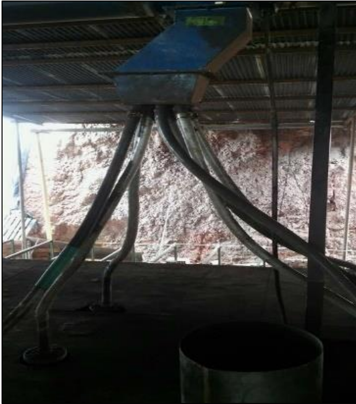
Ilustración 12. Inyección de Carbón al Horno Túnel Ladrillera Emalco
