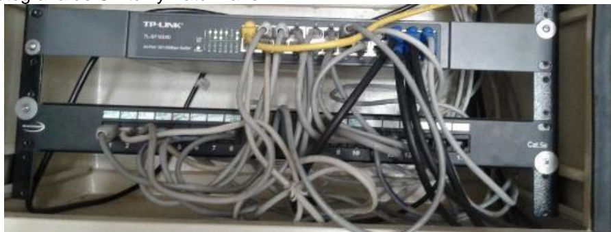
Figura 4: Fotografía de Switch y PatchPanel.
