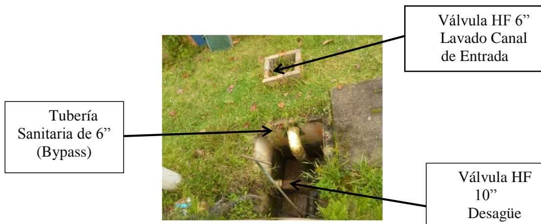
Imagen 25. Caja de Desagüe. Fuente: Autor
