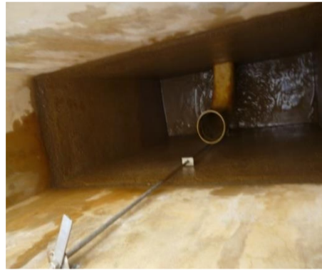
Imagen 27. Parte Interna Floculador. Fuente: Autor
