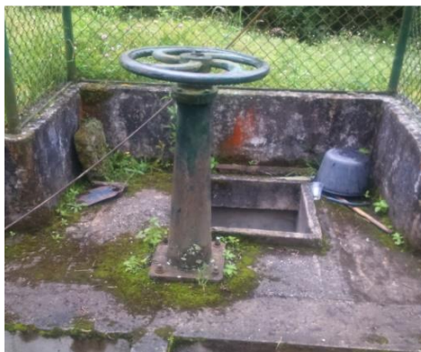
Imagen 14: Válvula de Lavado. Fuente: Autor
