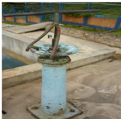
Imagen 34. Válvula Desague. Fuente: Autor
