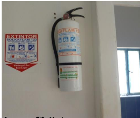
Imagen 53. Extintor. Fuente: Autor.
