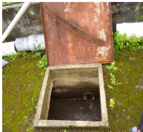
Imagen 16. Caja de Salida. Fuente: Autor
