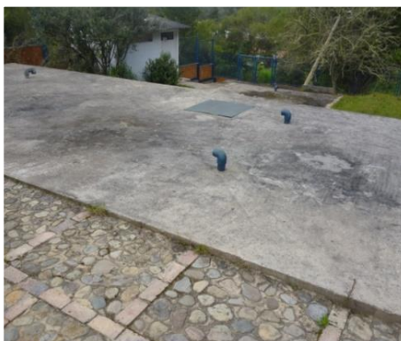
Imagen 43. Tanque N° 2. Fuente: Autor.
