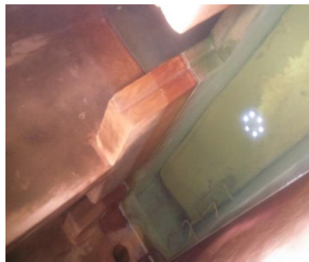
Imagen 38. Canaleta Salida Filtros. Fuente: Autor
