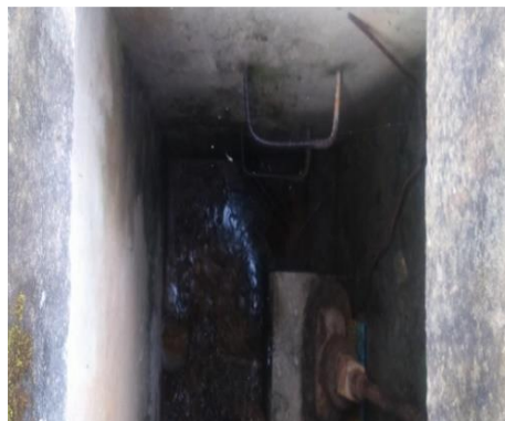
Imagen 15: Válvula de 10". Fuente: Autor
