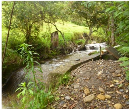
Imagen 10. Bocatoma La Única. Fuente: Autor
