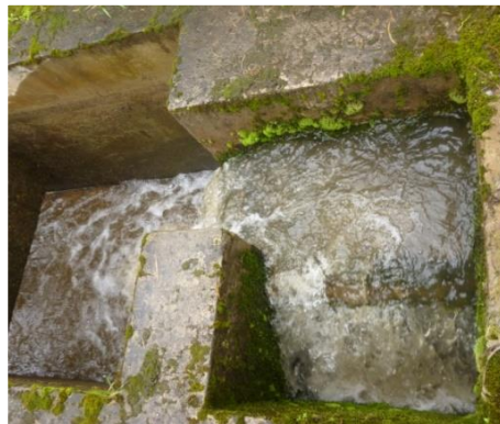
Imagen 13. Caja de Entrada. Fuente: Autor
