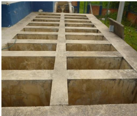
Imagen 26. Floculador. Fuente: Autor
