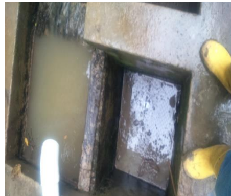
Imagen 7. Caja de Entrada. Fuente: Autor.
