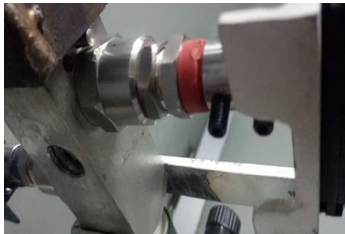
Figura 41. Automatización válvula presurización y despresurización, registro fotográfico dos. Fuente: El autor.
