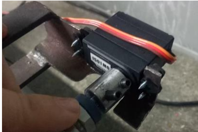
Figura 40. Automatización válvula presurización y despresurización, registro fotográfico uno. Fuente: El autor.
