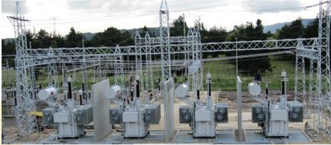
Figura 3. Banco de Autotransformadores. Fuente: Propia
