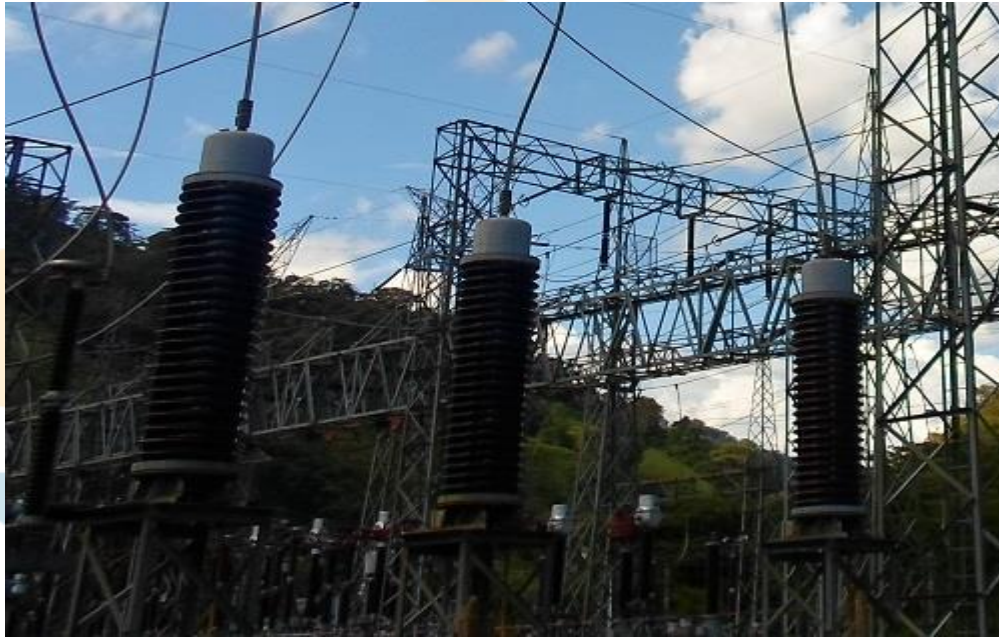
Figura 5. Transformadores de Potencial. Fuente: Propia
