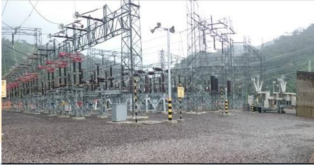
Figura 1. Patio de Subestación de Potencia. Fuente: Propia
