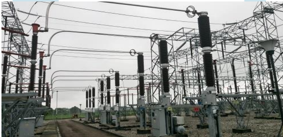
Figura 2. Interruptores de Potencia. Fuente: Propia
