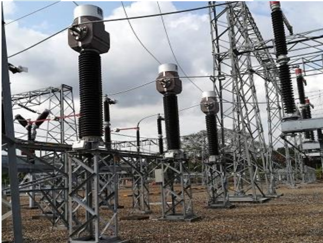
Figura 4. Transformadores de Corriente. Fuente: Propia
