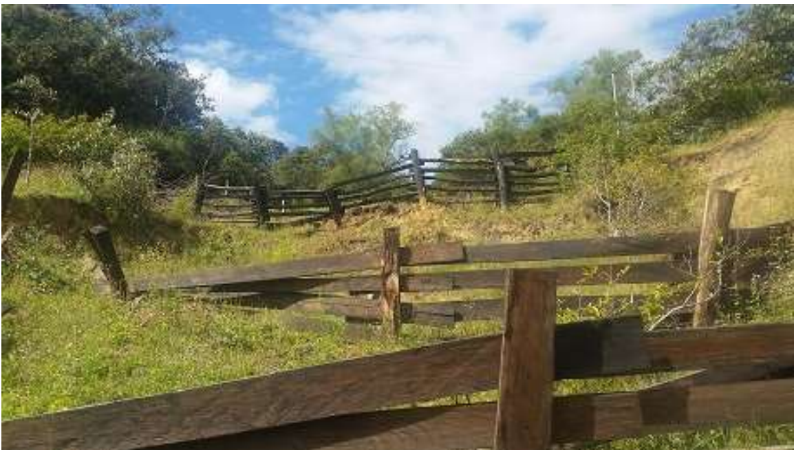
Suelo con trinchos mal ejecutados por parte de la Alcandía municipal
