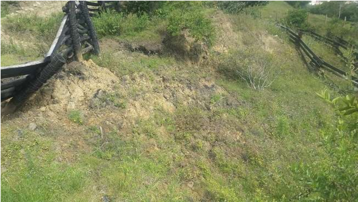
Zona con erosión
