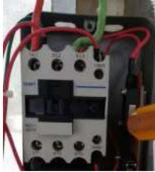
Figura 14. Interruptor de potencia (Contactor), Autoría propia.
