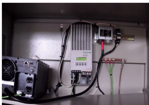
Figura 24 Controlador e inversor
