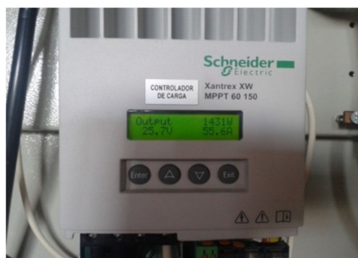
Figura 27 Pruebas del Sistema de energia en funcionamiento
