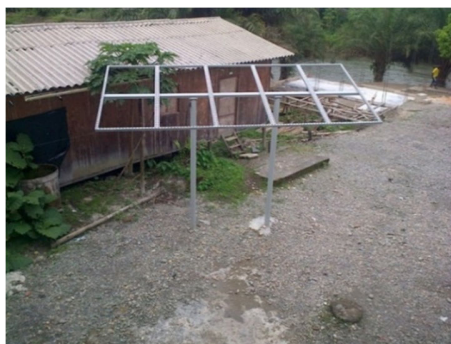
Figura 14 Infraestructura para los paneles solares
