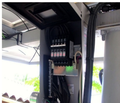
Figura 21: Breakers de los paneles
