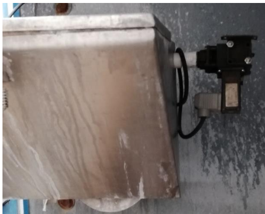
Flauta instalada con la válvula solenoide
