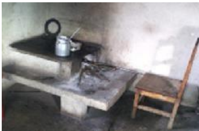
Imagen 4 Estructura rudimentaria en mampostería y repello
