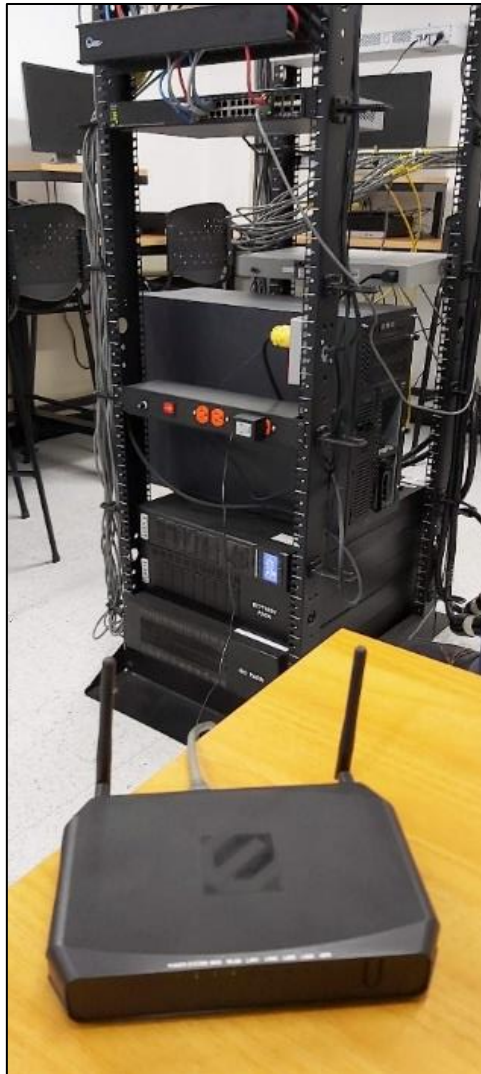
Figura 42. Instalación router sin restricciones
