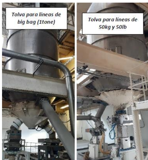
Ilustración 6. Imagen tolvas de recepción de producto terminado.
