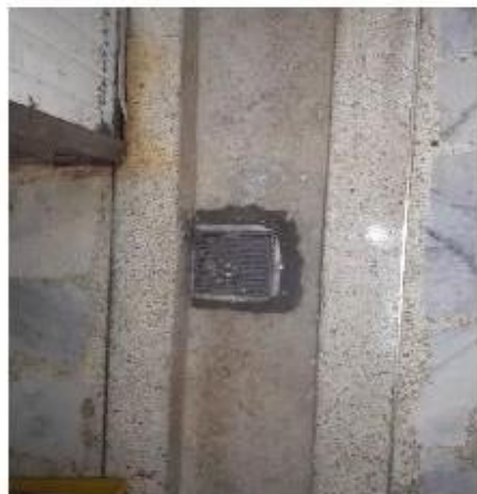
Sifones y canalinas
