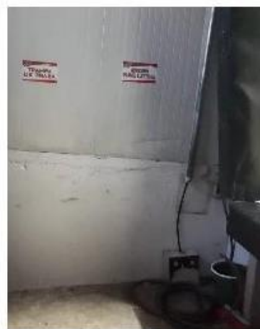
Trampa grasa- Colchón de acople- recepción
