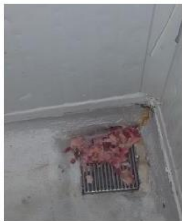
Residuos cárnicos - sifón
