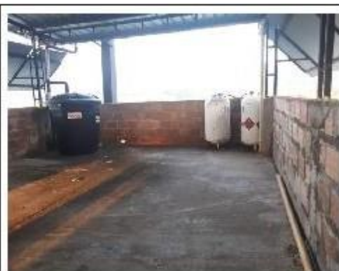
Tanque de agua- Gas
