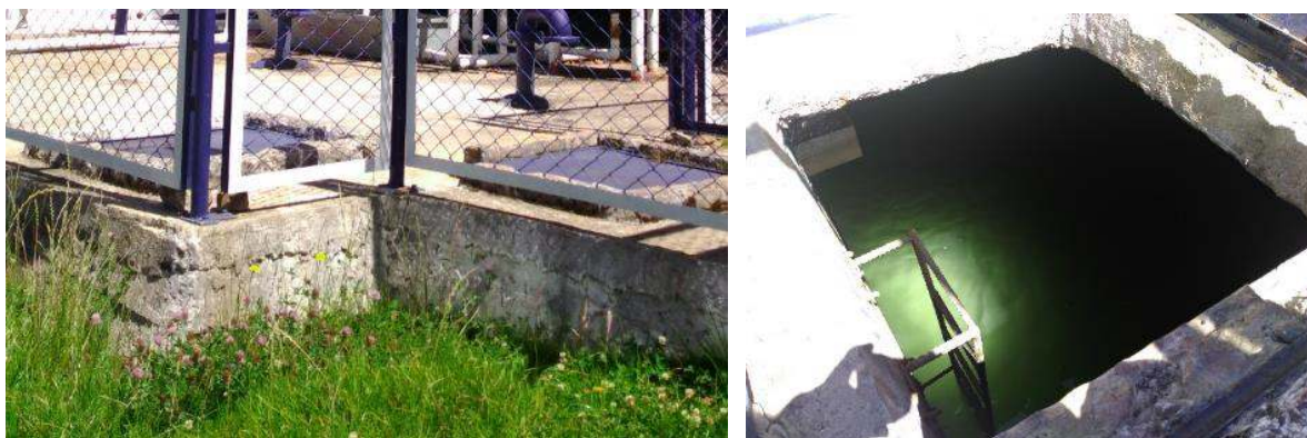
Imagen 15 Tanque de almacenamiento Acueducto Centro
