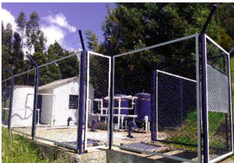
Imagen 14 PTAP Acueducto del sector centro
