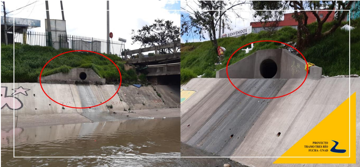
Ilustración 18 Puntos de descarga identificados en el punto 3 de monitoreo
