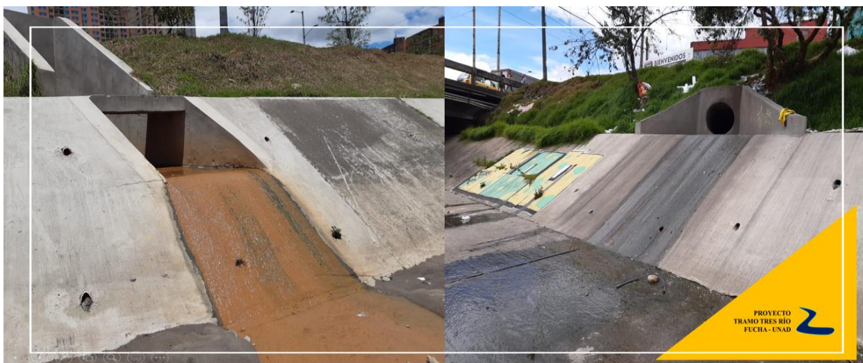
Ilustración 23 Vertimientos puntuales identificados en el tramo tres (3) del río Fucha.
