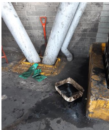
Figura 22. Derrame de hidrocarburo en Área de Mantenimiento preventivo
