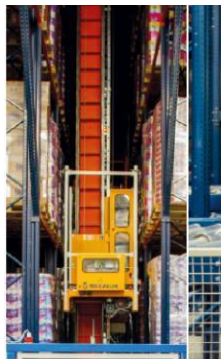
Ilustración 77. Equipos Automáticos instalados Mecalux
