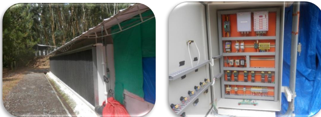
Figura 7 Sistema de ambiente controlado AVICOL. Fuente: El autor
