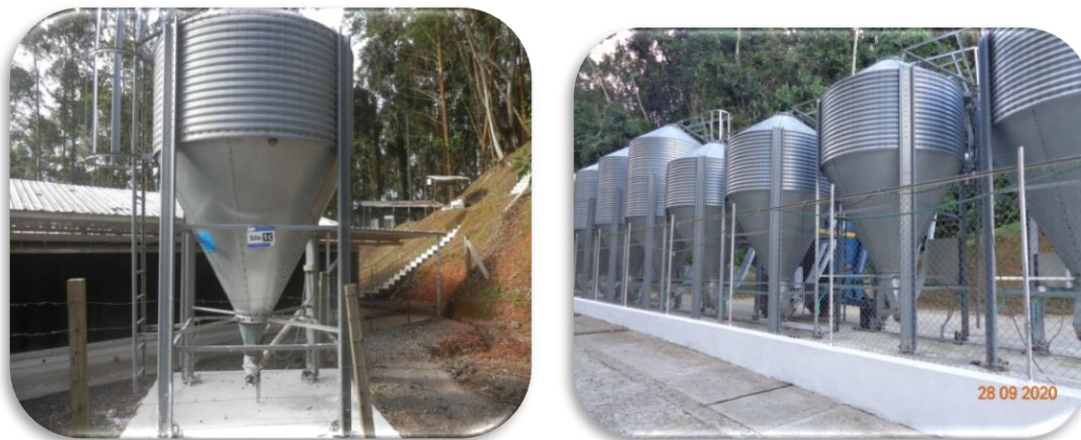
Figura 8 Sistema de silos de almacenamiento concentrado AVICOL. Fuente: El autor
