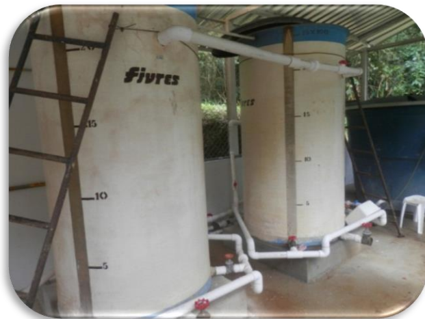
Figura 16 Planta de tratamiento de agua AVICOL. Fuente: El autor
