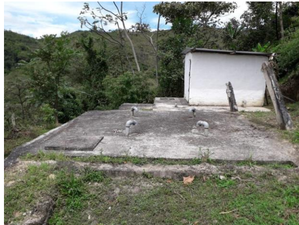
Figura 32. Tanque de almacenamiento
