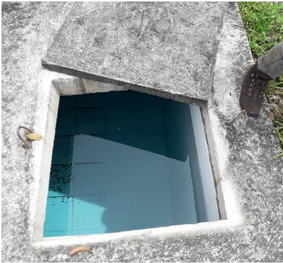
Figura 31. Interior tanque de almacenamiento
