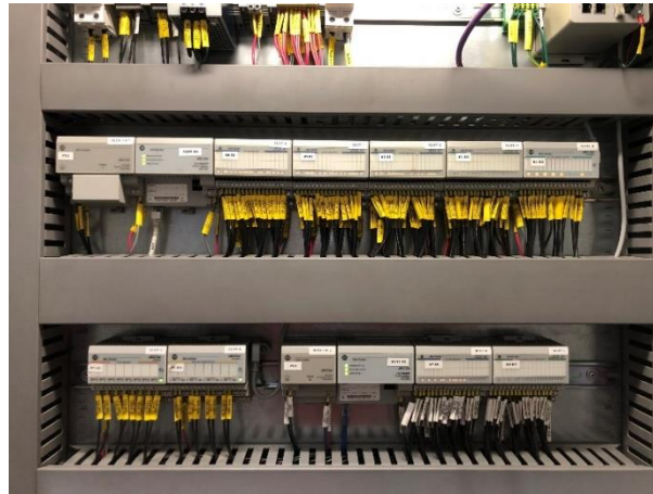
Figura 45. SLOT Celda Concentradora PLC's Extruder, Secado, Cobertura, Semielaborados
