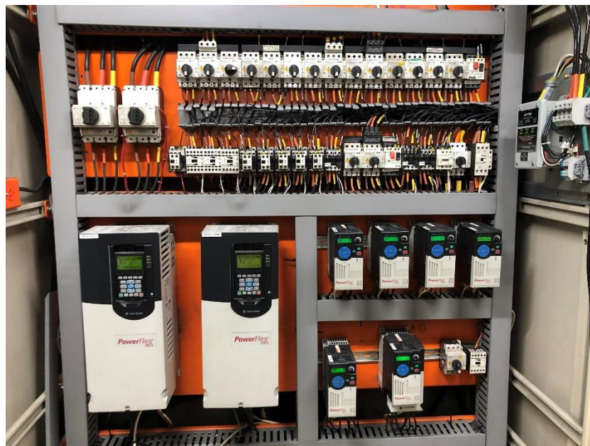
Figura 46. Tablero de control y potencia equipos proceso productivo cobertura
