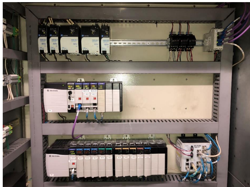
Figura 44. Celda Concentradora PLC's Extruder, Secado, Cobertura, Semielaborados
