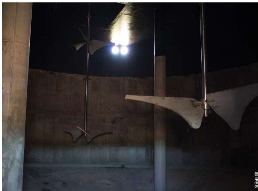
Figura 15 Vista interna de agitadores verticales de acero inoxidable
