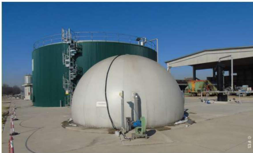
Figura 11 Biodigestores de mezcla completa de alta tecnología.
