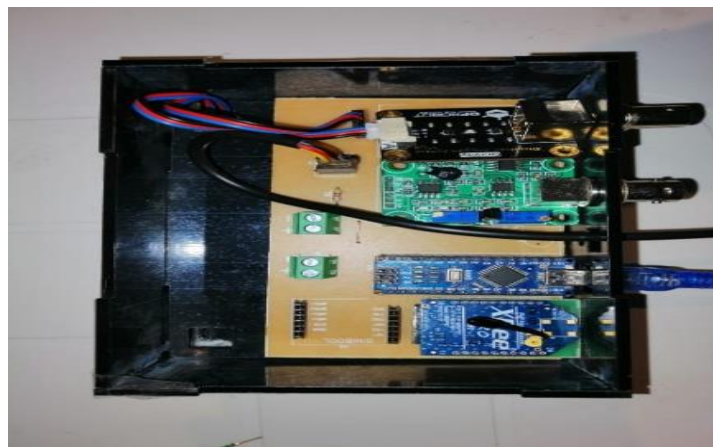
Figura 19. Dispositivo maestro instalado en la caja Fuente: Elaboración propia
