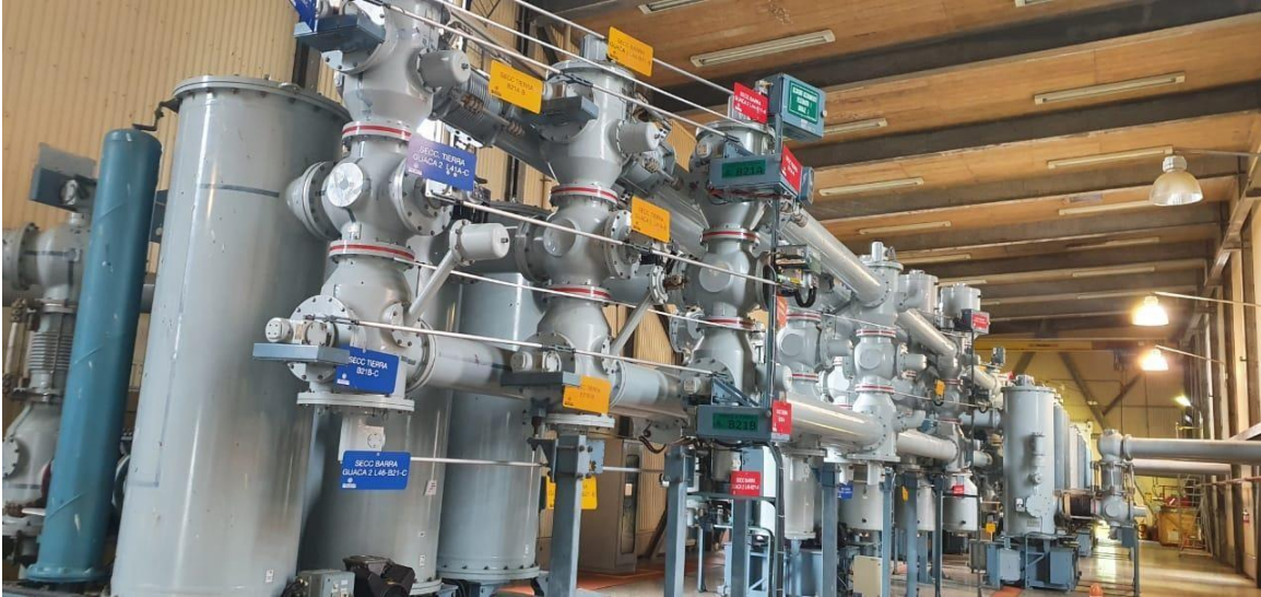
Subestación GIS de 230 kV de la central Hidroeléctrica el Paraiso
