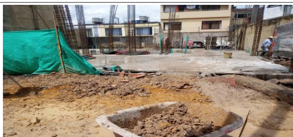
Imagen 18. Obra de Construcción de la Sra. Luz Marina cabrales García en el centro poblado de Sopó. Fuente J Daniel Yepes Gómez (2021)
