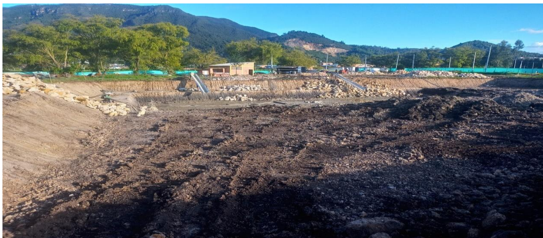
Imagen 43. PTAR municipal, Fuente J Daniel Yepes Gómez (2021)
