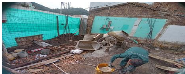
Imagen 14. Obra de construcción de la Sra. Maria Dolores Martinez ubicada en Sopó Centro. Fuente J Daniel Yepes Gómez (2021)
