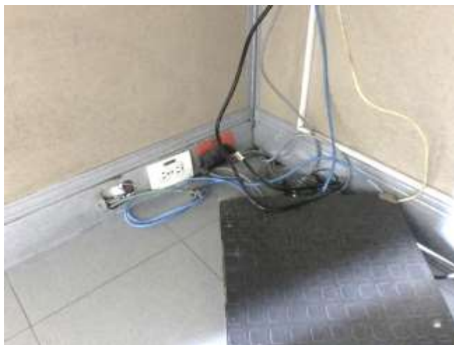
Figura 9. Puntos de red deteriorados o sueltos
